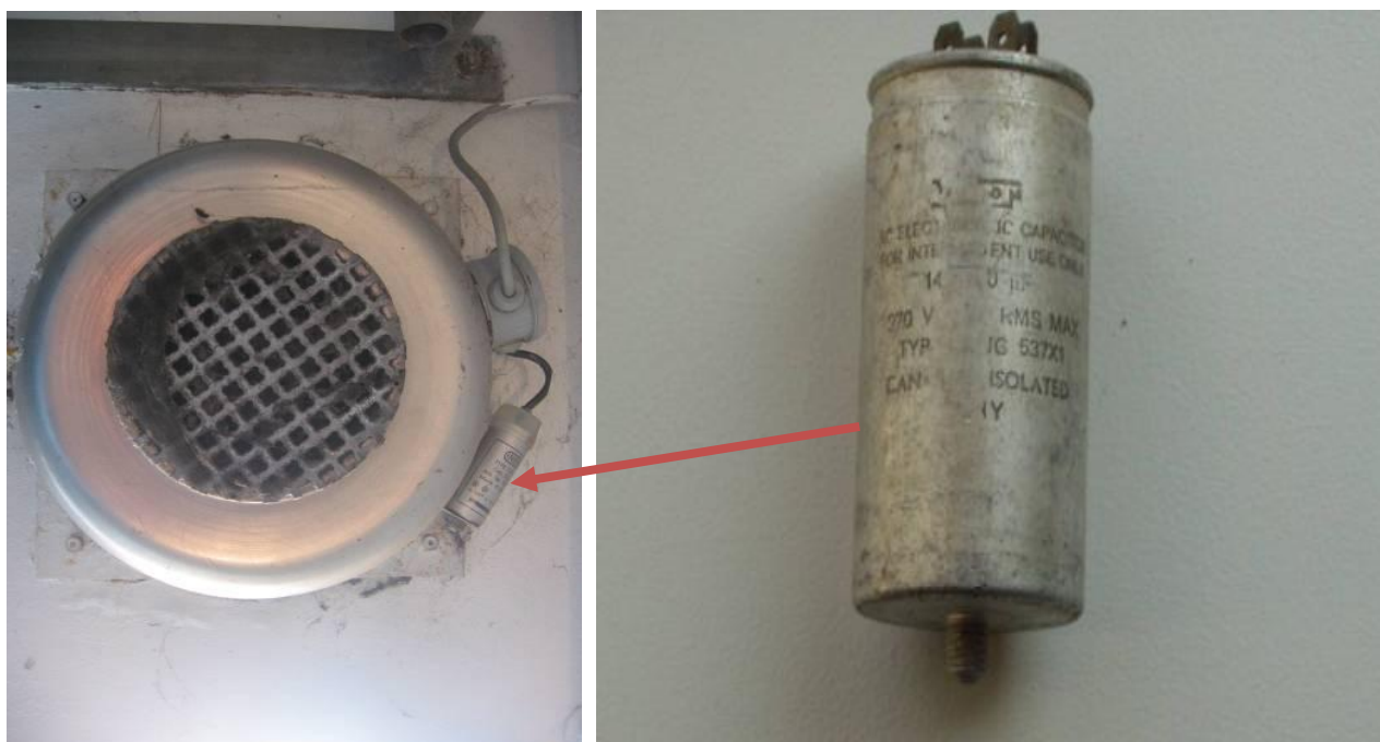
Foto: Eksempel på kondensator i forbindelse med motor til ventilator.
